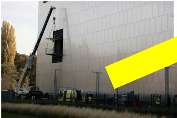
■ Bij het takelen van de vorklift tot zestien meter hoogte is er iets misgelopen, waarop het gevaarte naar beneden viel en op Guido Visser (52) terechtkwam. De ervaren werfleider overleed ter plaatse aan zijn verwondingen.
